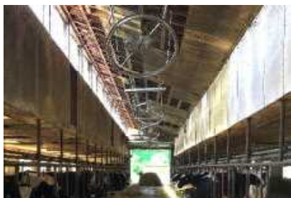
4台の送風機を天井に設置。対頭式の牛の鼻面を風が通り抜けます。
