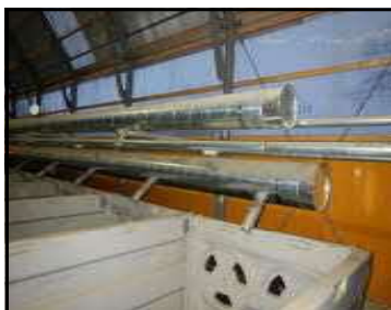
2本の配管は、下が温風機からの送風用で、上が温風機の廃熱で暖まった処理室の空気を送る管
