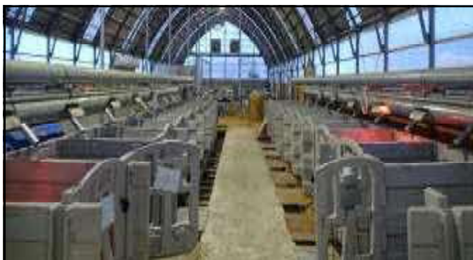
左右2本の温風配送管を並べ、別室のボイラーから温風を送風しています
