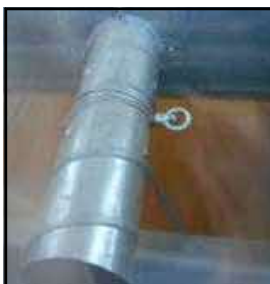
各送風口にはコックを付け、使用に応じて開閉可能
