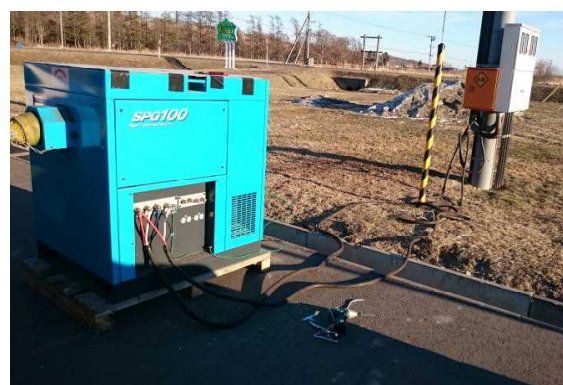
写真一 自家発電機（P.T.O.駆動式）
