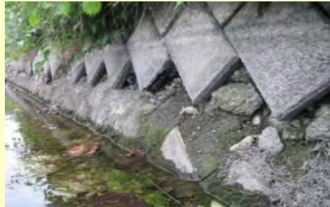
積ブロック水路の剥離状況
