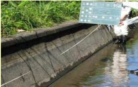
L型ブロック側壁のひび割れ状況
