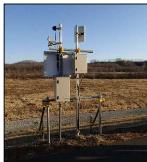
危機管理型水位計と同一箇所に設置された 簡易型河川監視カメラ（KP40.6 標茶町）
