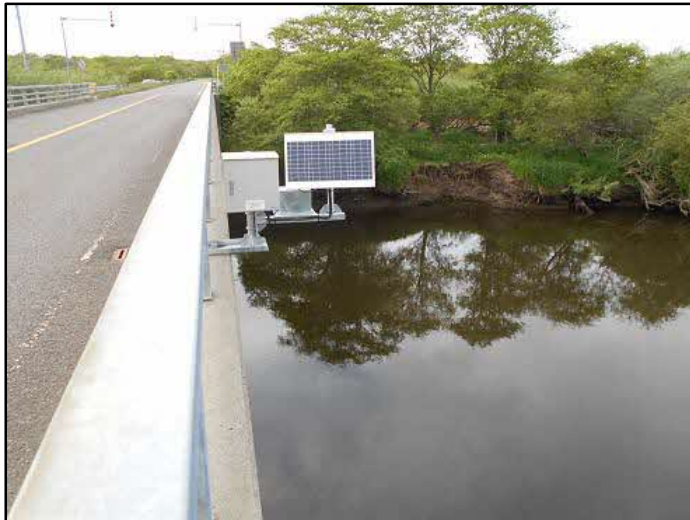
危機管理型水位計（根室市：風蓮川）
