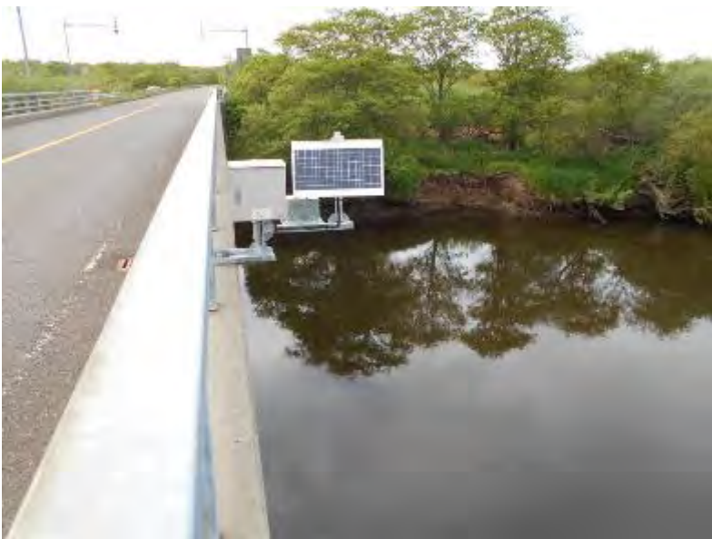
風連川(根室市)に設置した機器管理型水位計
